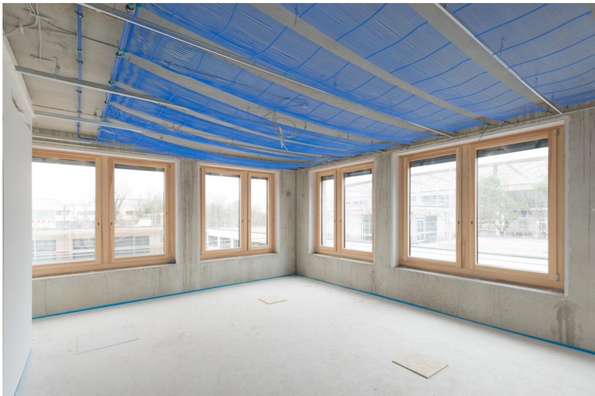
Die dreifachverglaste Fenster aus Holz sorgen für eine optimale Dämmung. Die Temperaturregelung erfolgt über die Raumdecke.
